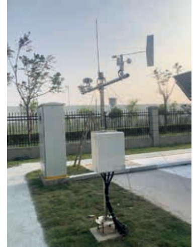
浙江海宁某光伏发电项目气象站
