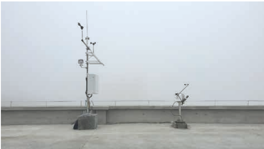
湖北襄阳某光伏发电项目气象站
