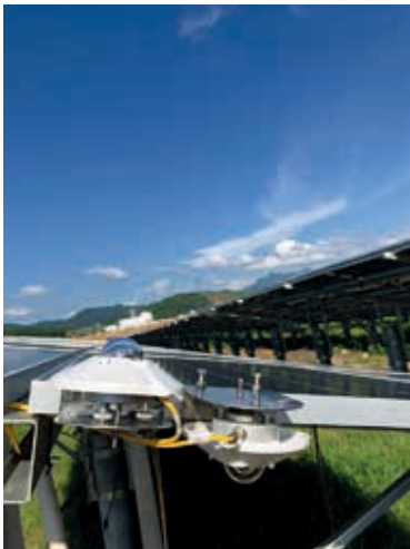
广东韶关某火电厂灰场光伏发电项目
