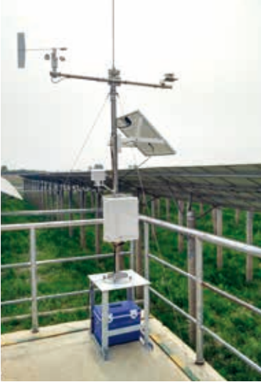
山东商河某光伏发电项目气象站
